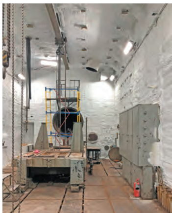
Рис. 10. ТБК высотного-климатического стенда ЦИАМ с новым теплоизоляционным покрытием
